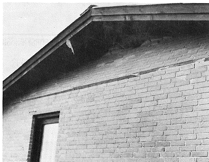
Figur 4. Murede gavltrekanter er ofte alene fastholdt i undersiden. Forankring til tagfladen er normalt også nødvendig. Den skadede gavl medfører overtryk i tagrummet og øger dermed risikoen for skader på tagbeklædningen og tagkonstruktionen i øvrigt.
