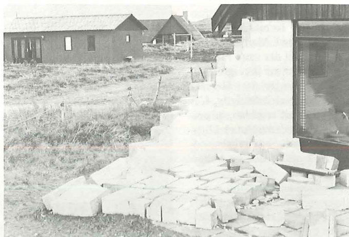
Figur 2. Alt for mange læmure af tegl eller letbeton opføres uden at være tilstrækkeligt afstivede.
