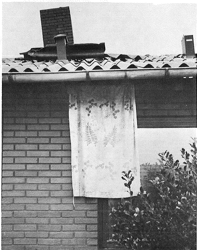
Figur 5. Et vindstød har lettet på taget og suget gardinet ud, hvorefter taget er faldet nogenlunde på plads igen, mens gardinet er kommet i klemme. Forankringen af taget til ydervæggene var foretaget med spinkle stålplakkebånd. (Foto: Tage Jensen).
