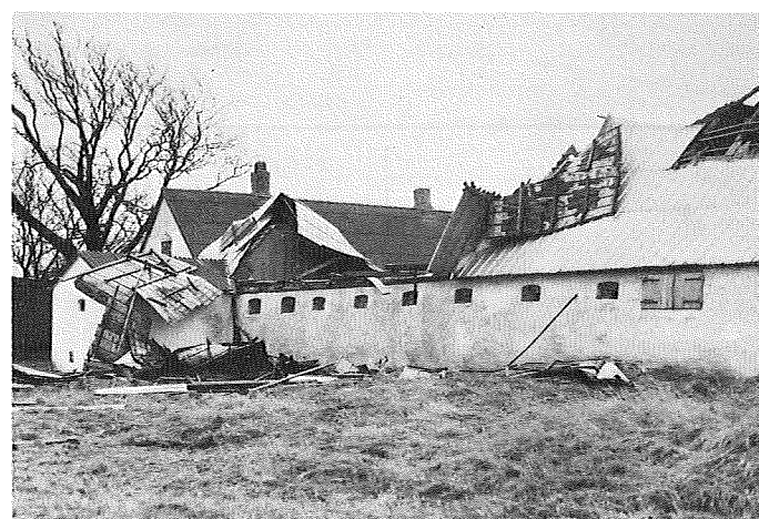
Figur 6. Mange ældre landbrugsbygninger blev ramt af omfattende stormskader. Årsagen er ofte fugtige trækonstruktioner i dårlig stand. En bedre vedligeholdelsesindsats og mere omtanke, når konstruktionsdele fjernes, ville forlænge levetiden for mange af disse bygninger.
