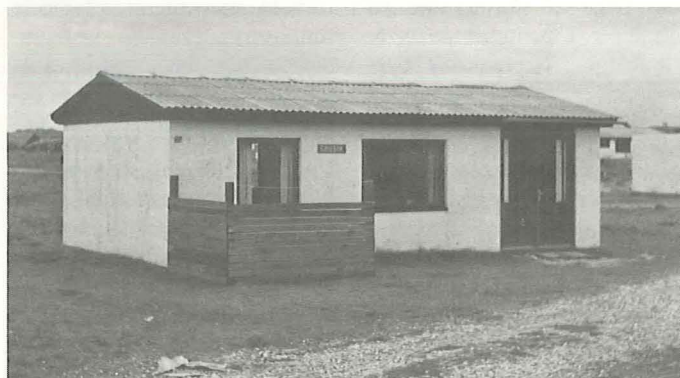
Figur 1. Sommerhuse opført af letbetonelementer med let 15° saddeltag. Tagene er ikke forankret til væggene. Stormen rev et tag helt af, hvorefter en dårligt afstivet gavlvæg tillige væltede. På godt halvdelen af de øvrige huse lettede og forskubbete taget sig, ligesom tagbeklædningen blev beskadiget.
